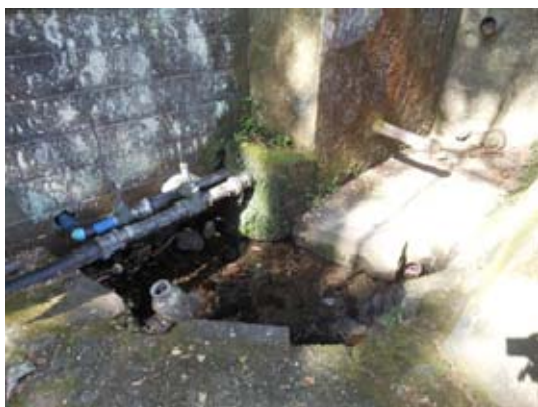
水道管 (湧水源)
