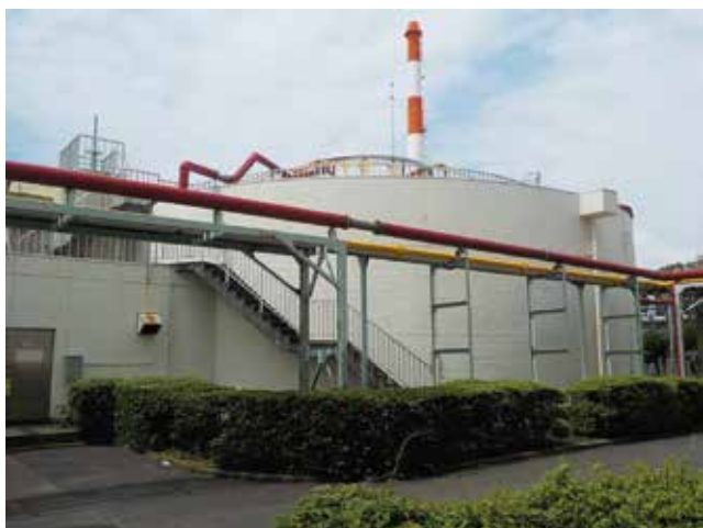
図 3-11 西部浄化センター消化槽
