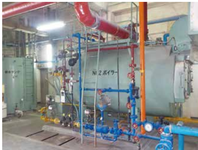
図 3-12 消化槽加温用ボイラー
