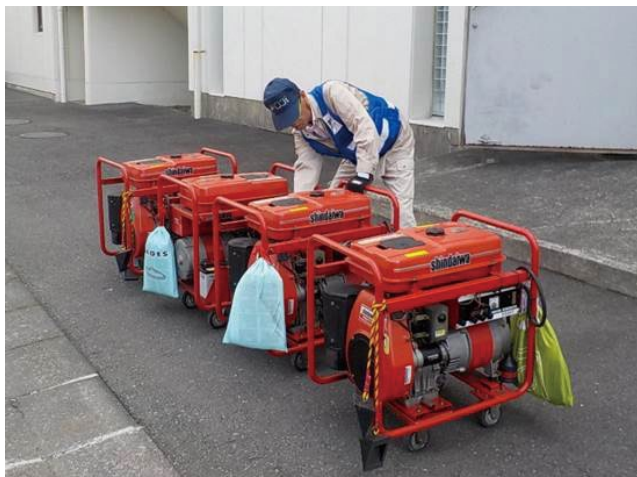
図 3-18 可搬式非常用自家発電機の試運転
