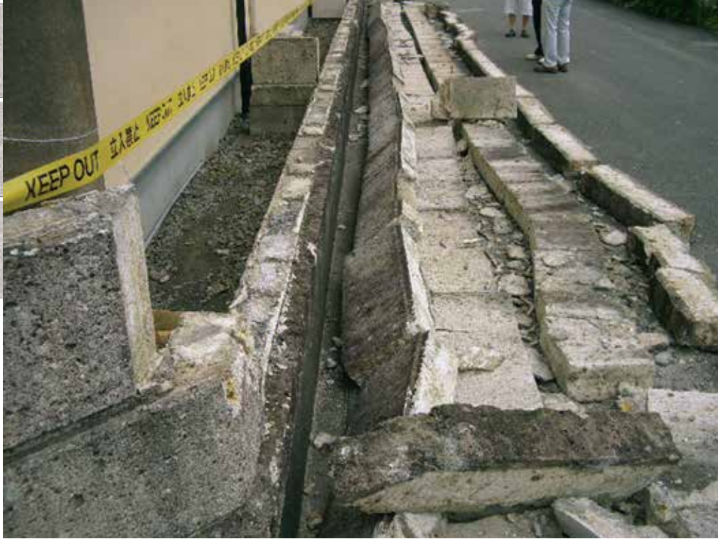
駿河湾を震源とする地震（平成23年8月1日発生）による大谷石塀の倒壊
