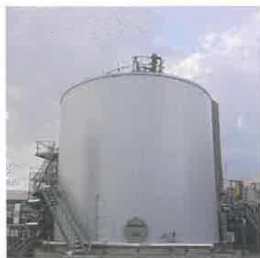
▲高濃度消化槽
