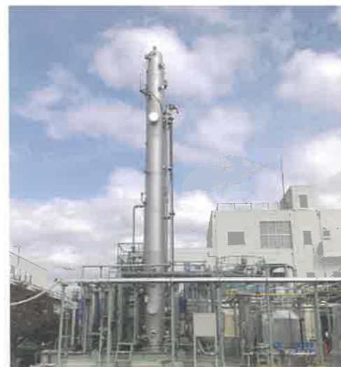
▲バイオガス精製装置
