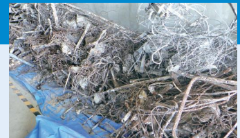
焼却炉に詰まった金属
