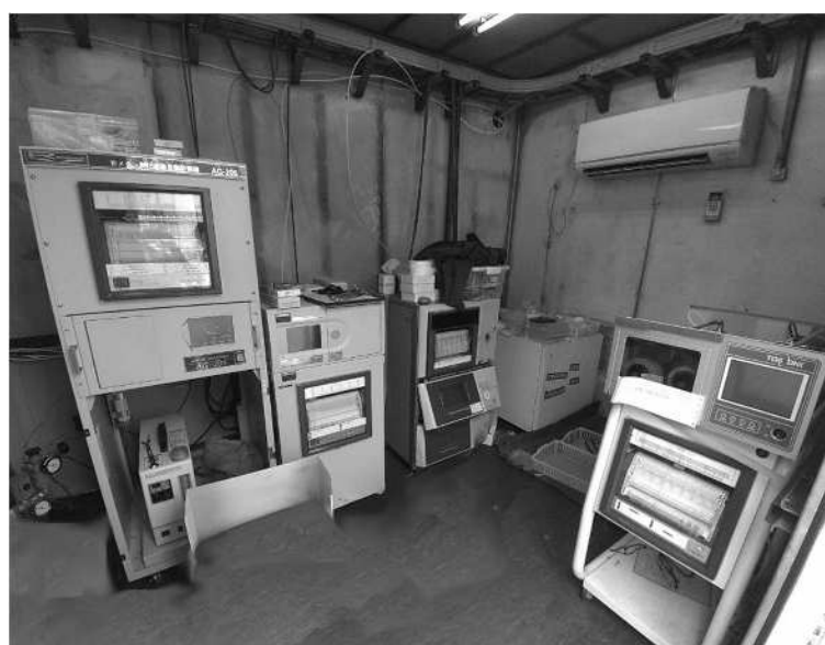
自排局の測定器と記録計 (自排宮島)
