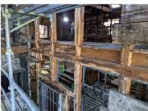
外壁 腐朽状況
