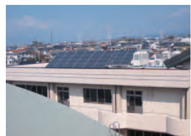
太陽光発電設備 (伝法まちづくりセンター)
