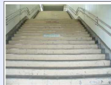
・階段のステップが分かりにくい。 → 同じ高さとするのが望ましい。 ・階段の中央に手すり等がなく歩きにくい。 → 手すりなどをつけてほしい。
