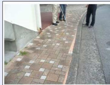
・路肩の整備（施工）が悪く、歩きづらい。 → きれいに整備してほしい。
