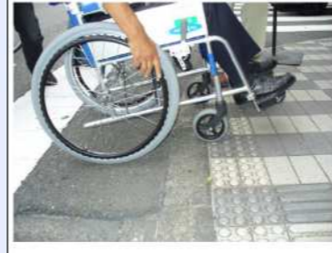
・横断歩道⇄歩道の段差が大きい。 →段差をなくす、もしくは小さくする。
