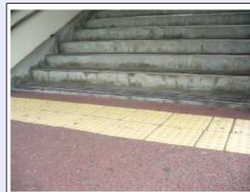
・階段の高さが異なる（一番下のみが低くなっている）。 → 同じ高さとするのが望ましい。
