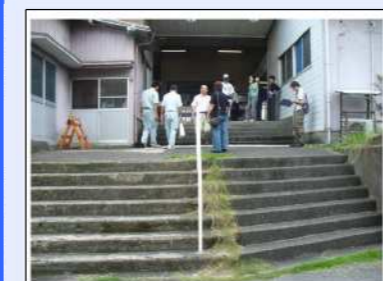
駅入口の階段の段差 → 段差の解消が必要。
