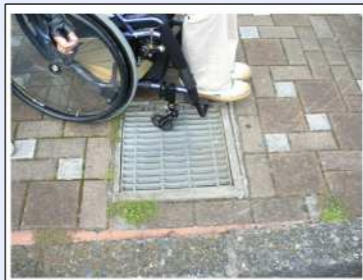
・集水柵の目が粗い。 → 細目の柵蓋に交換してほしい。
