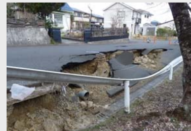
道路の陥没 (仙台市)
