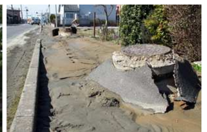
▲マンホールの浮き上がり 【東日本大震災/香取市】
