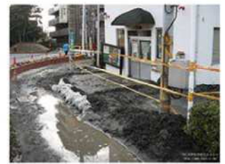
▲ 地盤沈下により傾いた交番
